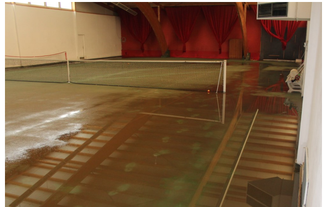
Ein enormer Schaden ist in der Tennishalle entstanden.
